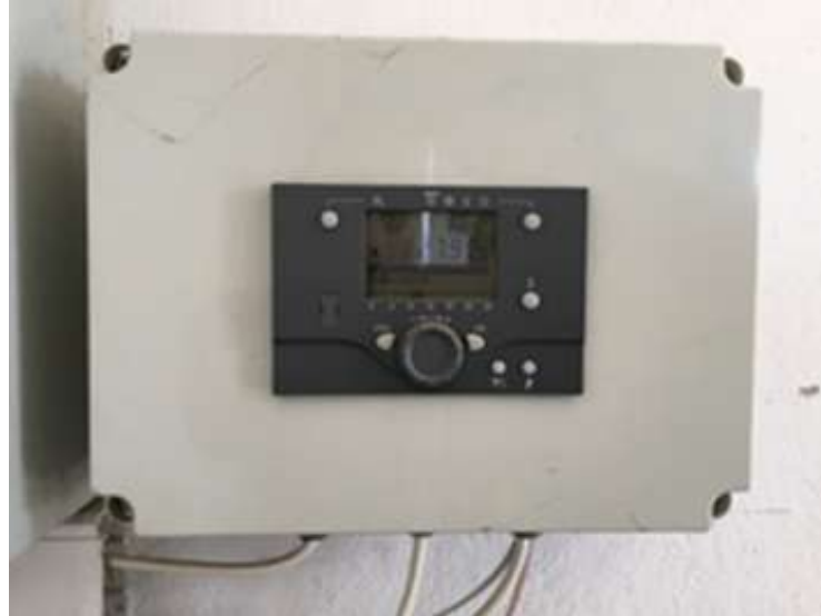
Şekil 3. Kazan kontrol paneli
