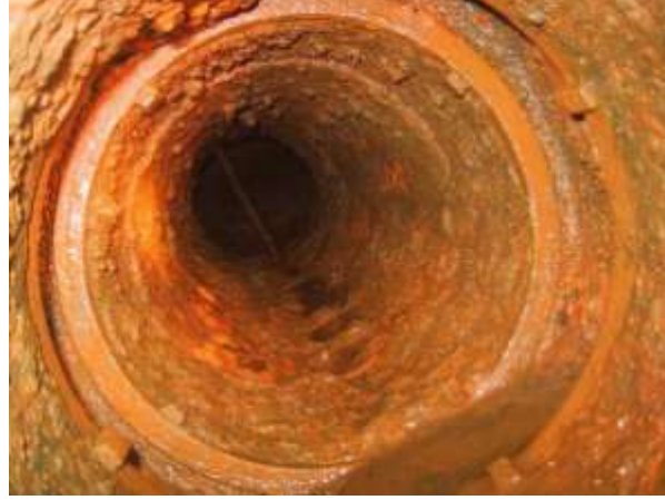
Şekil 6.6. Yıpranma ve korozyon
