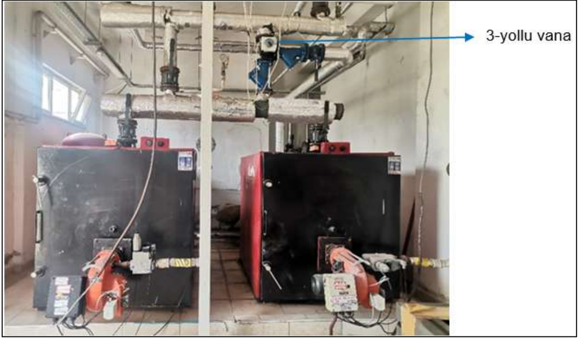
Şekil 2. 3-yollu motorlu vana montajı yapılmış kazan ve 3-yollu motorlu vananın konumu
