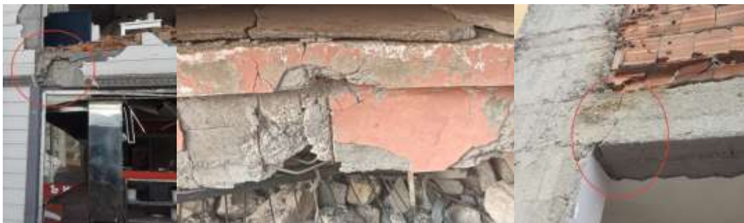
Şekil 1. BA kirişlerde meydana gelen hasarlar
