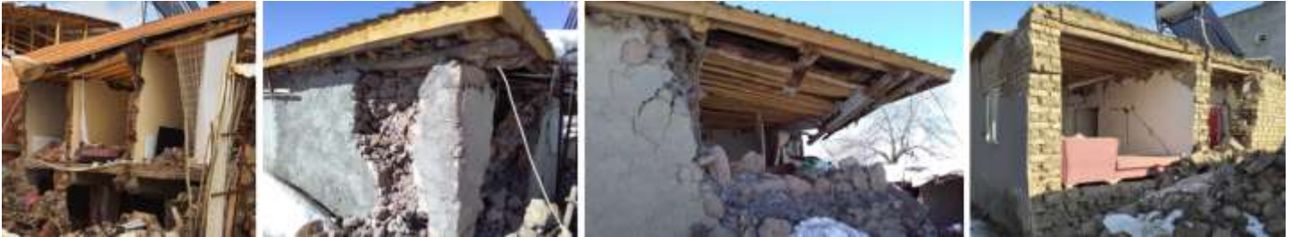
Şekil 2. Farklı düzeylerde hasar almış yığma yapı örnekleri
