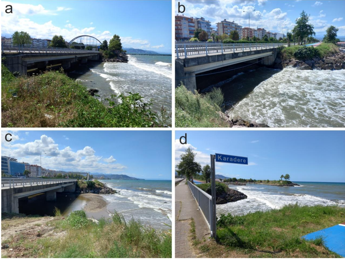
Şekil 6. Bulancak Deresi (a) Karadere (b) ve İncivez (c) dereleri üzerindeki KSY köprü altlarında dalga etkisi ve eğim azalmasına bağlı olarak malzeme birikmesi sonucu kesit daralması ve Karadere tarafından getirilen sediment malzemenin poyraz etkisiyle hemen batıdaki balıkçı barınağına dolması (foto tarih: 25 Ağustos 2023)
