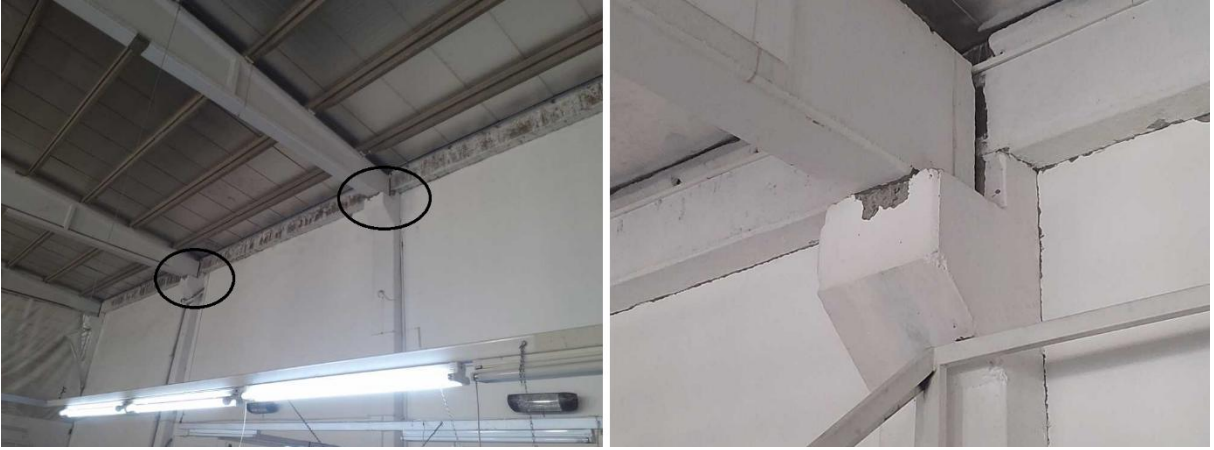
Şekil 7. Prefabrik betonarme kolonlardaki yerel hasarlar
