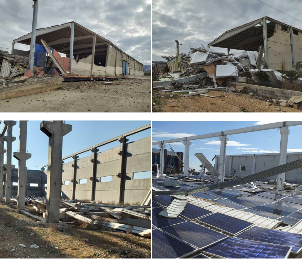
Şekil 5. Kiriş-kolon birleşim zayıflığından kaynaklı yapı çökmesi
