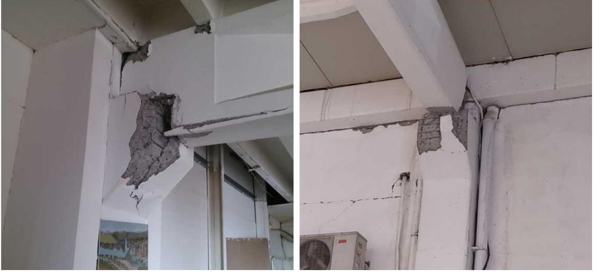
Şekil 6. Kiriş-kolon birleşim bölgesi hasarları
