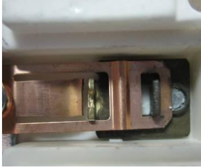
Resim 4: 1.Açma kapama değerleri hatalı (Bakır paslanma, kontak yapışma)
