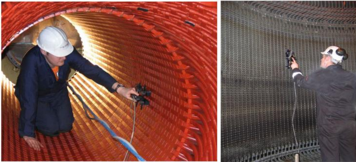
Şekil 4 (a) Turbo-jeneratörde ELCID testi, (b) Hidro-jeneratörde ELCID testi
