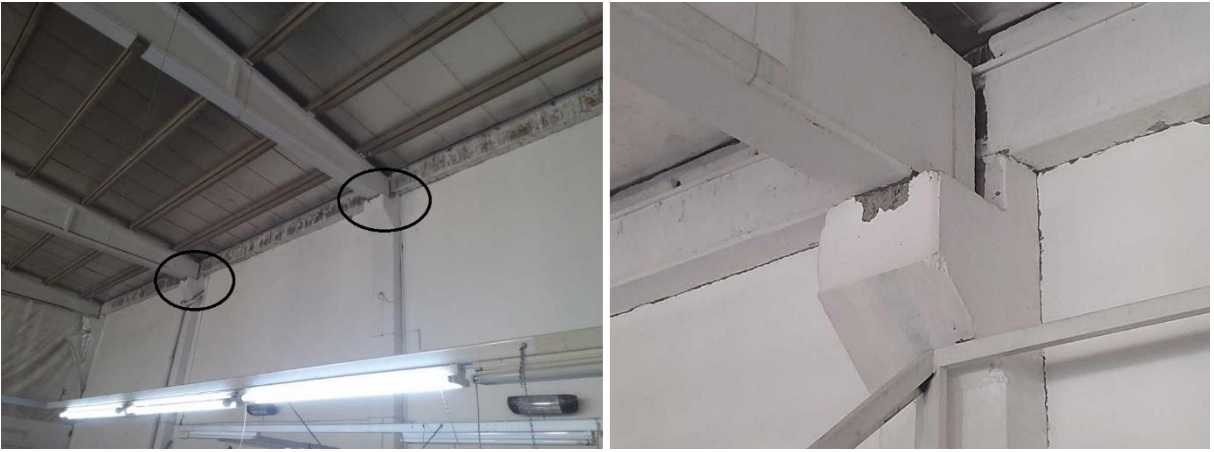
Şekil 7. Prefabrik betonarme kolonlardaki yerel hasarlar
